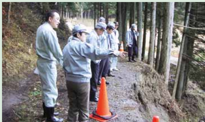
▲町道崩落現場の確認（北山字双石地内）
