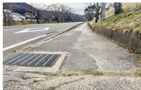
老朽化した歩道
