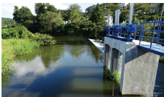
▲堆砂で河床が上がり、河川断面を狭くしている。 水郡線鉄橋(上)、猫啼堰(下)
