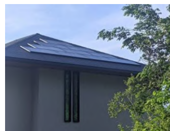
【太陽光発電設備】
