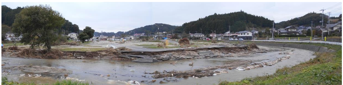
被害状況(護岸の流出箇所)
