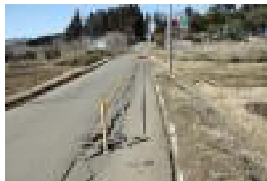
東日本大震災により被災した道路の状況
